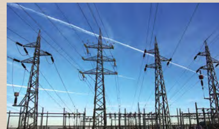
Tepelná elektrárň Planta Centro, Venezuela
