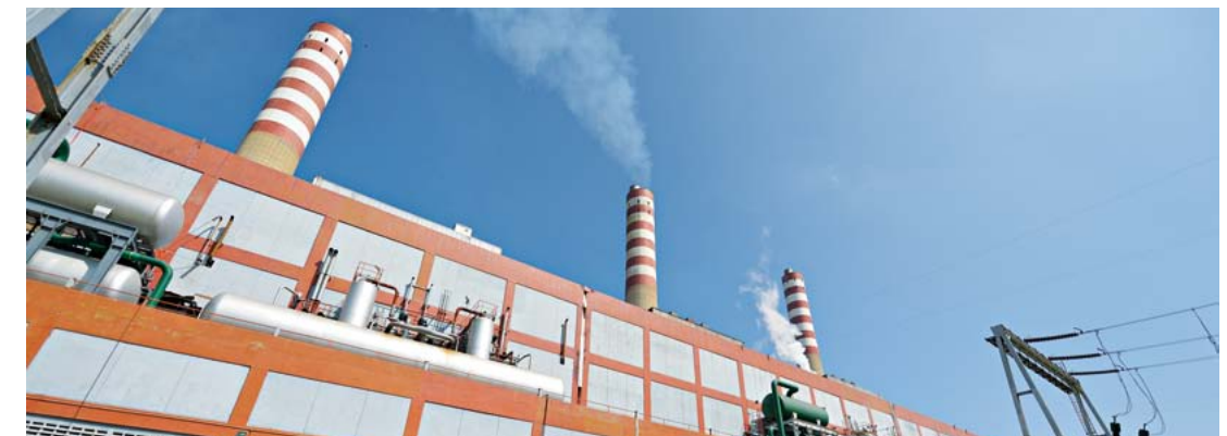
Tepelná elektrárň Planta Centro, Venezuela
